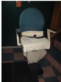
Treppenlift zum Zimmer
